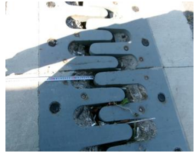
③ 신축이음 A2 여유량 부족 - 주기적인 계측 필요
