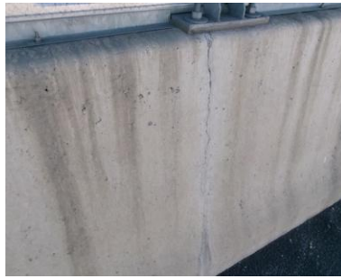
② 방호벽 균열 및 균열부백태 - 진전 여부확인
